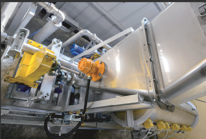
処理装置 原料投入部
